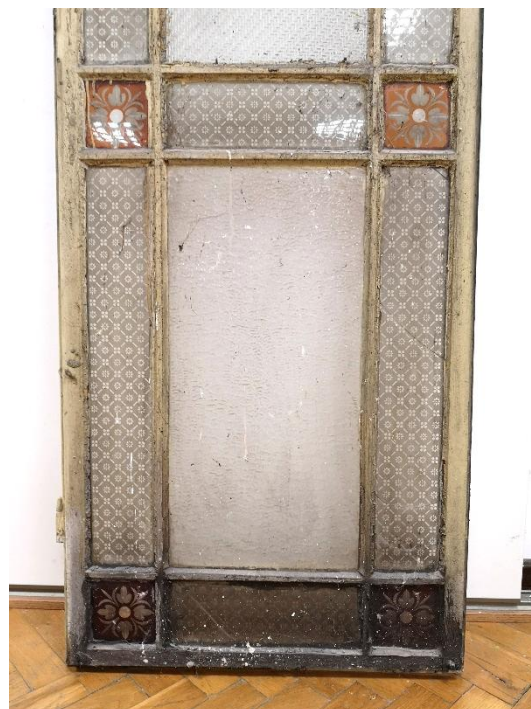
Il. 242. Jedno ze skrzydeł okna klatki schodowej w kamienicy przy ul. Jagiellończyka 4. Widoczne zabrudzenia powierzchni (Fot. Adam Kaźmierczak).
