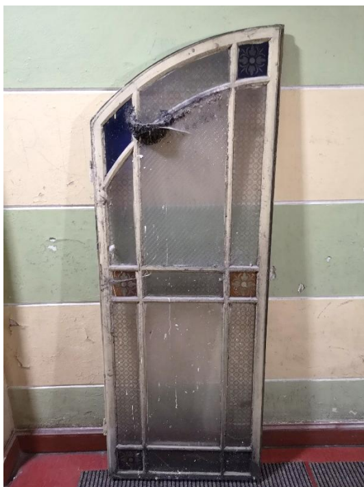
Il. 241. Jedno ze skrzydeł okna klatki schodowej w kamienicy przy ul. Jagiellończyka 4. Widoczne zabrudzenia powierzchni oraz jaskółcze gniazdo (Fot. Adam Kaźmierczak).
