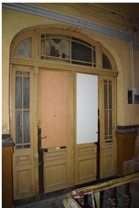
Il. 245. Jedne z drzwi z widocznymi różnymi uszkodzeniami na klatce schodowej w kamienicy przy ul. Szerokiej 26-28 (Fot. Adam Kaźmierczak).
