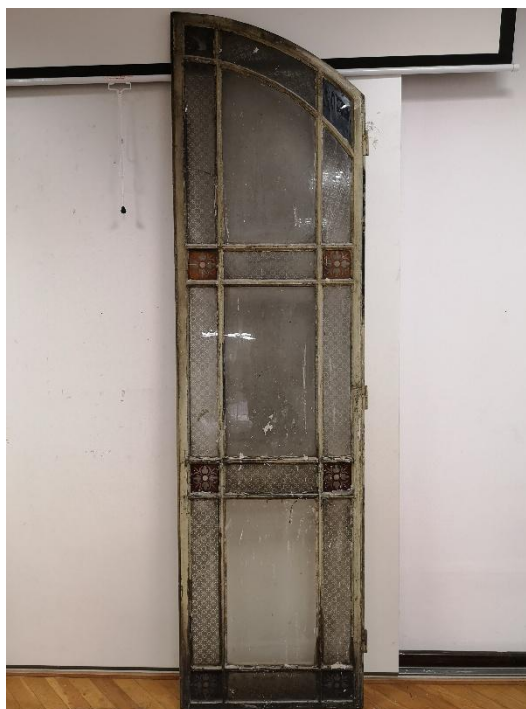
Il. 202. Skrzydło trzeciego okna półpiętra klatki schodowej w kamienicy przy ul. Jagiellończyka 4. Widoczne zachowane szkło matowe dwóch górnych głównych pól. Powierzchnia szkła i ramy jest mocno zabrudzona (Fot. Adam Kaźmierczak).
