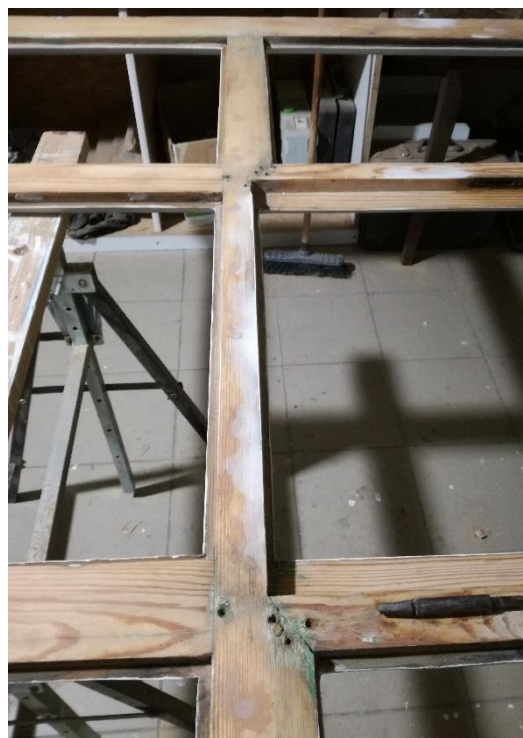
Il. 236. Okno czwartego półpiętra klatki schodowej w kamienicy przy ul. Poniatowskiego 1 z widocznymi uszkodzeniami narożnych połączeń stolarskich. Stan po usunięciu przemalowań (Fot. Malwina Lewandowicz).
