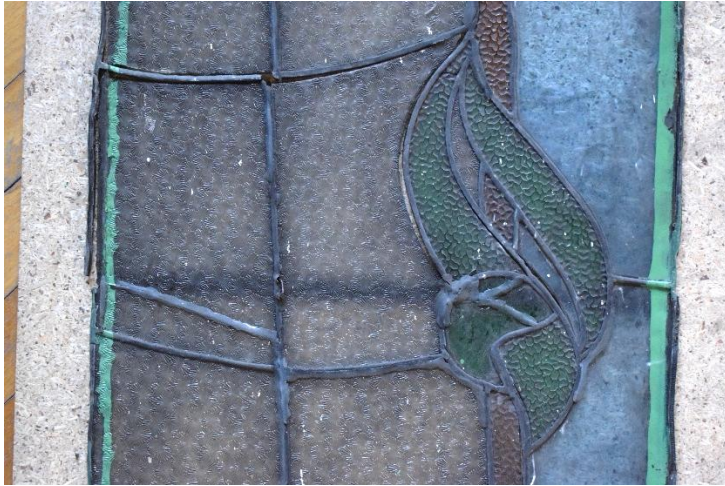
Il. 193. Fragment kwatery trzeciego okna półpiętra w kamienicy przy ul. Poniatowskiego 1. Widoczne zabrudzenia, silikonowe spoiny w pęknięciach szkła oraz spękania ołowiu (Fot. Adam Kaźmierczak).
