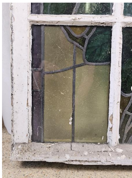
Il. 234. Zniszczenia okapnika jednej z kwater okna klatki schodowej w budynku przy Placu Rapackiego 1 (Fot. Adam Kaźmierczak).
