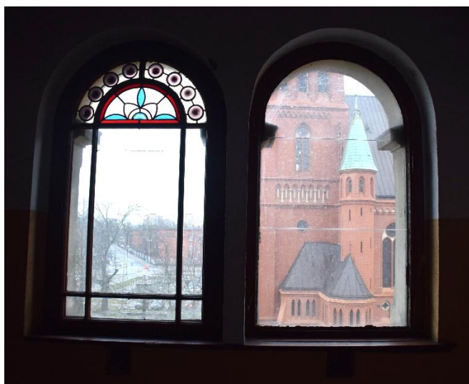
Il. 240. Okna biforialne trzeciego półpiętra klatki schodowej w kamienicy przy Placu św. Katarzyny 4. Prawy otwór pozbawiony całego skrzydła okiennego (Fot. Adam Kaźmierczak).
