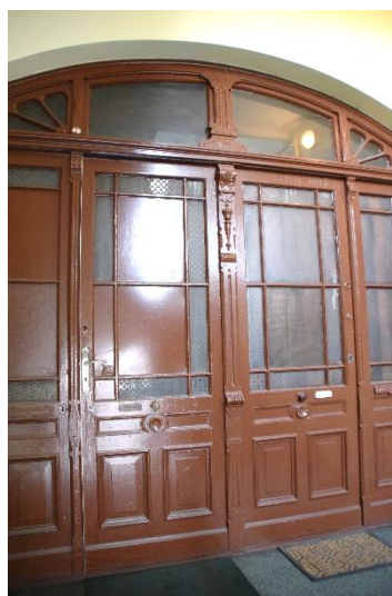
Il. 172. Drzwi do mieszkań kamienicy przy ul. Warszawskiej 6 z widocznymi prześwitami wtórnie zabitymi płytami drewnopochodnymi (Fot. Adam Kaźmierczak).
