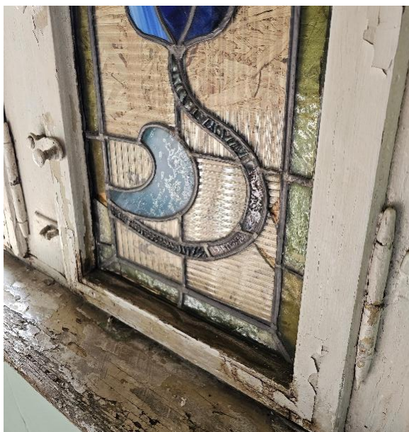
Il. 233. Zniszczenia dolnego ramiaka oraz parapetu jednego z okien klatki schodowej w kamienicy przy ul. Kopernika 42 (Fot. Adam Kaźmierczak).
