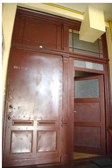
Il. 171. Drzwi do mieszkań kamienicy przy ul. Warszawskiej 2 z widocznymi prześwitami wtórnie zabitymi płytami drewnopochodnymi (Fot. Adam Kaźmierczak).
