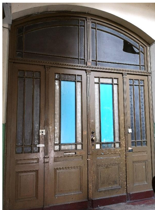
Il. 246. Uszkodzone drzwi do jednego z mieszkań w kamienicy przy ul. Klonowica 24 (Fot. Adam Kaźmierczak).
