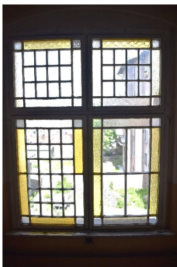
Il. 239. Ubytki podziału szprosowego w jednym z okien klatki schodowej w kamienicy przy ul. Sienkiewicza 11 (Fot. Adam Kaźmierczak).
