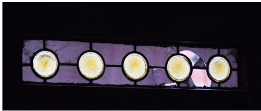
Il. 179. Uszkodzenia ołowiu i szkła witrażu gomółkowego w nadświetlu drzwi wejściowych do kamienicy przy Placu św. Katarzyny 4 (Fot. Adam Kaźmierczak).
