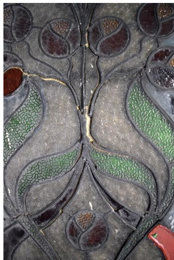
Il. 191. Fragment kwatery witrażu drugiego półpiętra z kamienicy przy ul. Poniatowskiego 1. Widoczne zabrudzenia oraz zniszczenia listew ołowianych (Fot. Adam Kaźmierczak).
