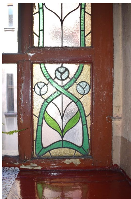
Il. 238. Uszkodzenia połączeń stolarskich i złuszczenia farby jednego z okien klatki schodowej w kamienicy przy ul. Most Pauliński 12 (Fot. Adam Kaźmierczak).
