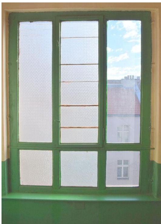
Il. 235. Okno czwartego półpiętra klatki schodowej w kamienicy przy ul. Poniatowskiego 1 z widocznym stalowym prętem nad dolnym rzędem kwater, pełniący funkcję wtórnego wzmocnienia osłabionej konstrukcji (Fot. Adam Kaźmierczak).
