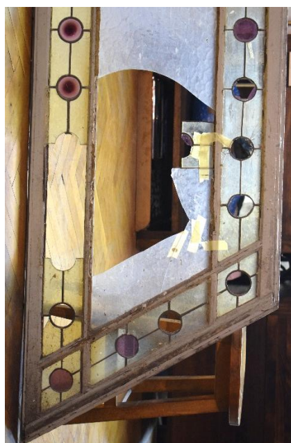
Il. 213. Zniszczenia witraży i oszklenia okna pierwszego półpiętra klatki schodowej w kamienicy przy ul Jagiellończyka 6 (Fot. Adam Kaźmierczak).
