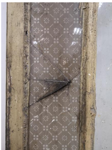
Il. 203. Fragment skrzydła okiennego pierwszego półpiętra klatki schodowej w kamienicy przy ul. Jagiellończyka 4. Widoczne pęknięcia szkła i silne zabrudzenia powierzchni (Fot. Adam Kaźmierczak).
