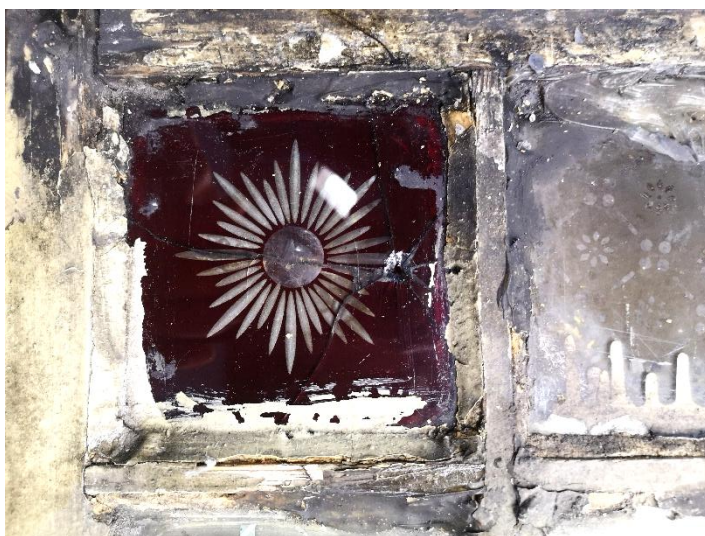
Il. 205. Dolna część skrzydła okiennego pierwszego półpiętra klatki schodowej w kamienicy przy ul. Jagiellończyka 4. Rozetka z dziurą po pocisku wystrzelonym prawdopodobnie z wiatrówki (Fot. Adam Kaźmierczak).
