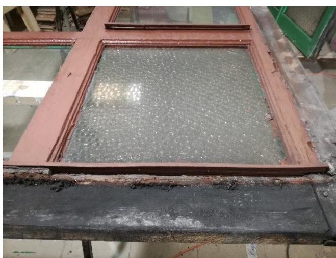
Il. 244. Osady sadzy na obokniu jednego z okien klatki schodowej w kamienicy przy ul. Poniatowskiego 1 (Fot. Malwina Lewandowicz).
