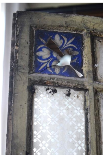
Il. 199. Potłuczona narożna szlifowana rozetka okna trzeciego półpiętra klatki schodowej w kamienicy przy ul. Jagiellończyka 4 (Fot. Adam Kaźmierczak).
