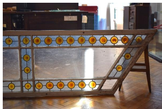
Il. 216. Ubytek narożnej kwatery okna trzeciego półpiętra klatki schodowej w kamienicy przy ul Jagiellończyka 6 (Fot. Adam Kaźmierczak).
