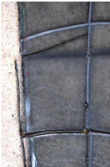
Il. 195. Fragment kwatery trzeciego okna półpiętra w kamienicy przy ul. Poniatowskiego 1. Widoczne zabrudzenia, w tym zacieki po wiatrownicy oraz spękania i ubytki ołowiu (Fot. Adam Kaźmierczak).
