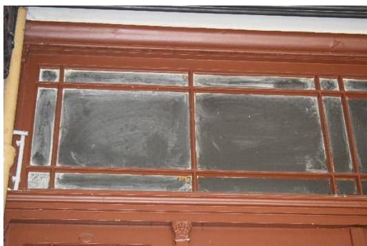
Il. 175. Zabrudzenia nadświetla drzwi do mieszkania w kamienicy przy ul. Sienkiewicza 11 (Fot. Adam Kaźmierczak).
