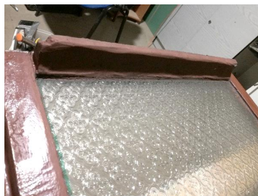
Il. 232. Uszkodzenia okapnika i profili ramiaków jednego ze skrzydeł okna klatki schodowej w kamienicy przy ul. Poniatowskiego 1 (Fot. Malwina Lewandowicz).
