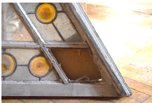
Il. 231. Uszkodzenia okapnika jednego ze skrzydeł okna klatki schodowej w kamienicy przy ul. Jagiellończyka 6 (Fot. Adam Kaźmierczak).
