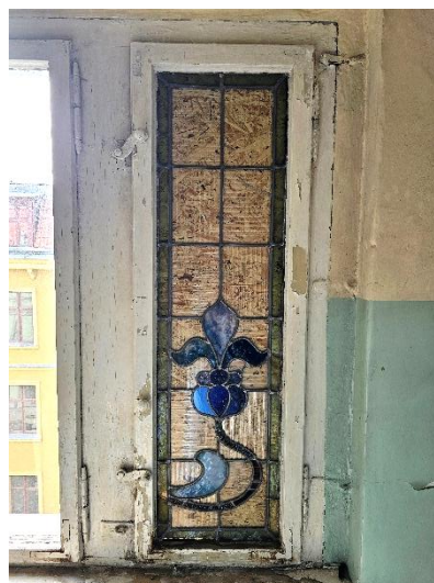
Il. 174. Skrzydło z witrażem klatki schodowej kamienicy przy ul. Kopernika 42 zabite płytą OSB (Fot. Adam Kaźmierczak).
