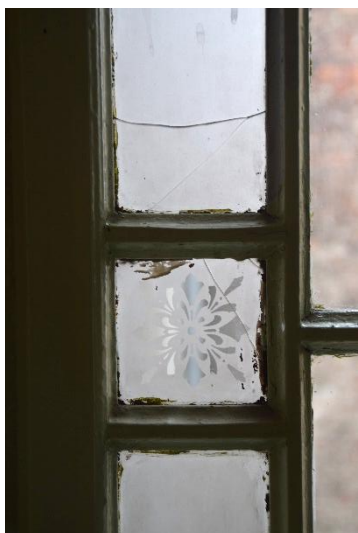
Il. 169. Spękania i zabrudzenia szkła okna klatki schodowej w kamienicy przy ul. Warszawskiej 14 (Fot. Adam Kaźmierczak).
