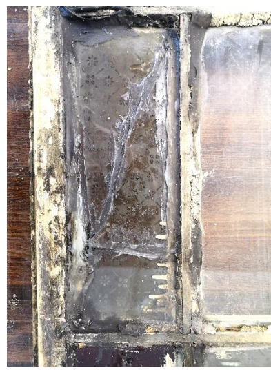
Il. 206. Dolna część skrzydła okiennego pierwszego półpiętra klatki schodowej w kamienicy przy ul. Jagiellończyka 4. Widoczne pęknięcia i ubytek szkła klejone silikonem (Fot. Adam Kaźmierczak).
