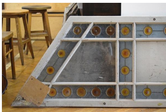
Il. 215. Ubytek narożnej kwatery okna trzeciego półpiętra klatki schodowej w kamienicy przy ul Jagiellończyka 6 zabity drewnopochodną płytą (Fot. Adam Kaźmierczak).
