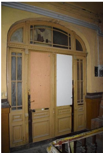
Il. 173. Drzwi do mieszkania w kamienicy przy ul. Szerokiej 26-28 z widocznymi prześwitami wtórnie zabitymi płytami drewnopochodnymi (Fot. Adam Kaźmierczak).
