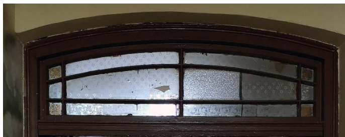
Il. 170. Spękania, ubytki i zabrudzenia szkła nadświetła drzwi wahadłowych w kamienicy przy ul. Sienkiewicza 22 (Fot. Adam Kaźmierczak).
