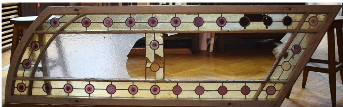
Il. 214. Zniszczenia witraży i oszklenia okna pierwszego półpiętra klatki schodowej w kamienicy przy ul Jagiellończyka 6 (Fot. Adam Kaźmierczak).
