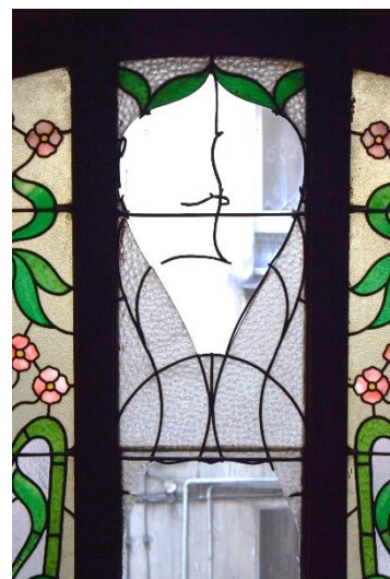
Il. 178. Deformacje ołowiu i ubytki szkła w kwaterze okna klatki schodowej kamienicy przy ul. Most Pauliński 12 (Fot. Adam Kaźmierczak).
