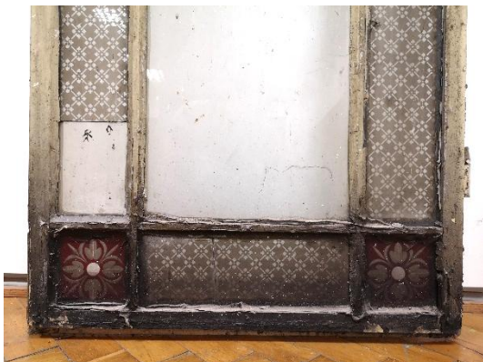
Il. 207. Dolna część skrzydła okiennego drugiego półpiętra klatki schodowej w kamienicy przy ul. Jagiellończyka 4. Widoczne wtórne uzupełnienia pól szklami okiennymi klejone silikonem (Fot. Adam Kaźmierczak).
