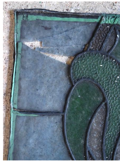
Il. 196. Fragment kwatery trzeciego okna półpiętra w kamienicy przy ul. Poniatowskiego 1. Widoczne zabrudzenia, spękania i ubytki szkła (Fot. Adam Kaźmierczak).
