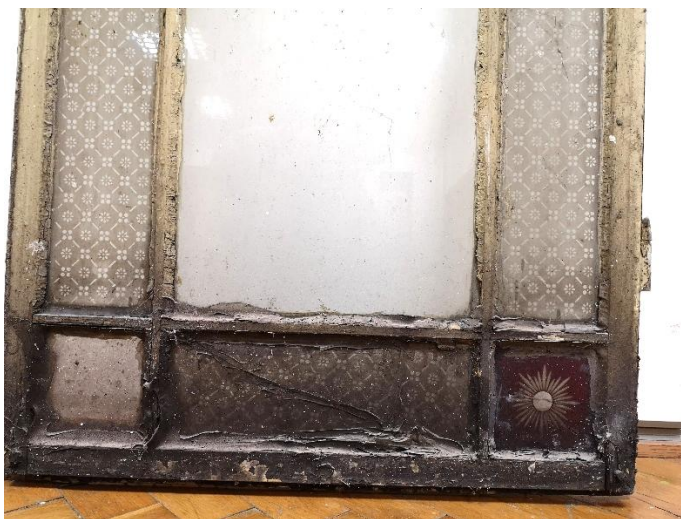
Il. 204. Dolna część skrzydła okiennego pierwszego półpiętra klatki schodowej w kamienicy przy ul. Jagiellończyka 4. Widoczne wtórne uzupełnienia pól szklami okiennymi, pęknięcia szkła klejone silikonem oraz rozetkę z dziurą po pocisku wystrzelonym prawdopodobnie z wiatrówki (Fot. Adam Kaźmierczak).
