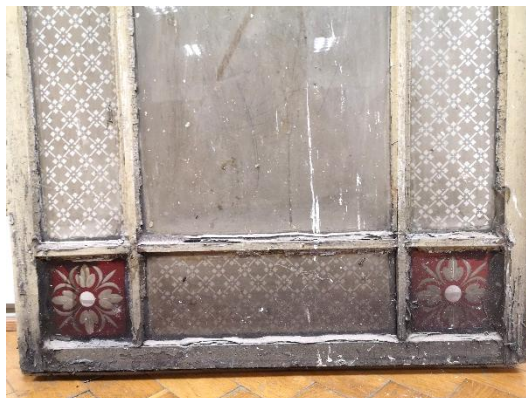
Il. 208. Dolna część skrzydła okiennego drugiego półpiętra klatki schodowej w kamienicy przy ul. Jagiellończyka 4. Widoczne uzupełnienia ubytków kitów silikonem (Fot. Adam Kaźmierczak).
